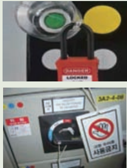
LOTO(Lock Out/Tag Out) 설치
