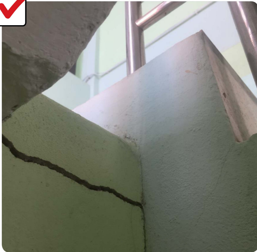
건물 균열 확인
